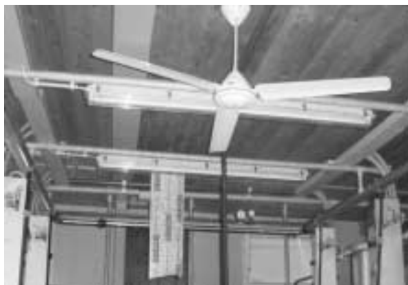
Deckenventilatoren kühlen im Sommer und vertreiben Fliegen.
